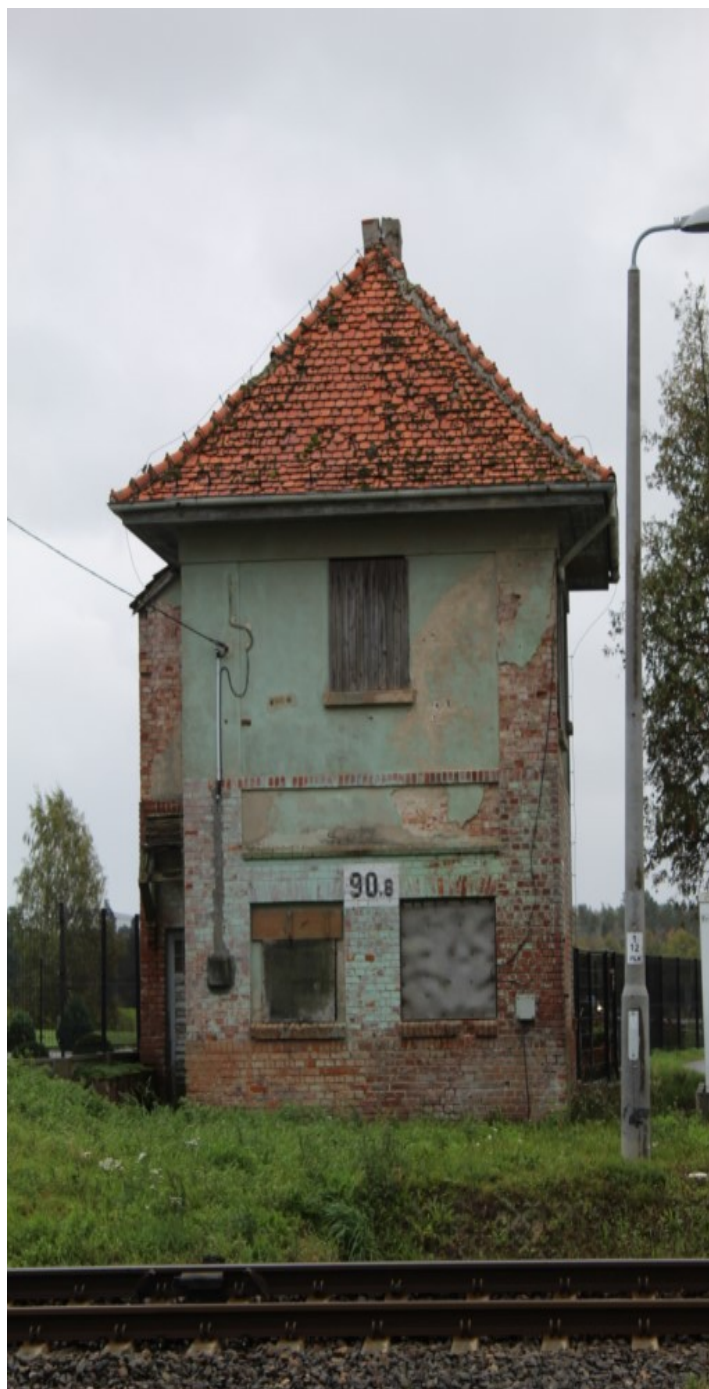
Ilustracja 154. Krojanty ul. 18 Pułku Piechoty Ułanów Pomorskich 2, transformatorownia.
